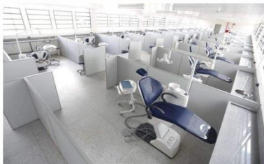
Detalhe da clínica instalada
